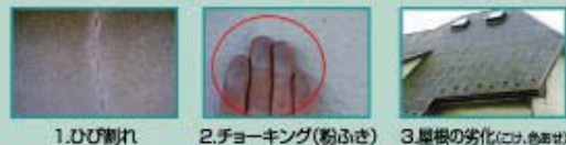
1.ひび割れ 2.チョーキング(粉ふき) 3.屋根の劣化(こけ、色あせ)
