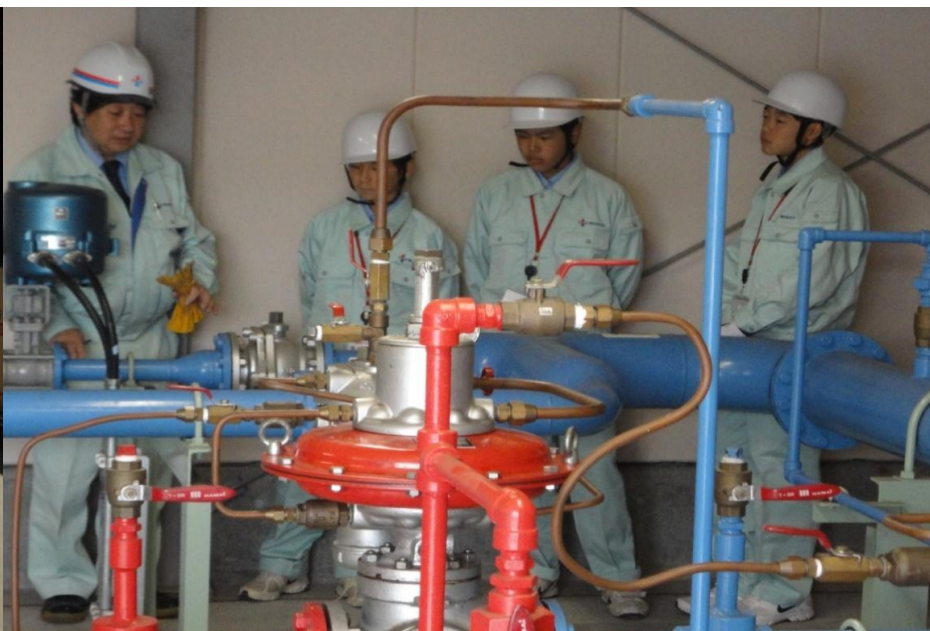
供給設備(整圧器)点検
